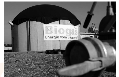
Installation de stockage de biogas
